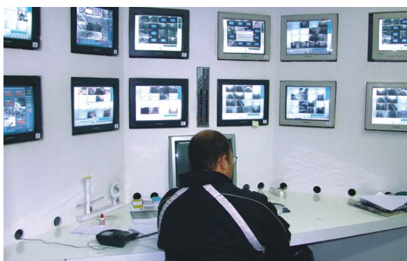
Sala da Segurança - Controle e Monitoramento
