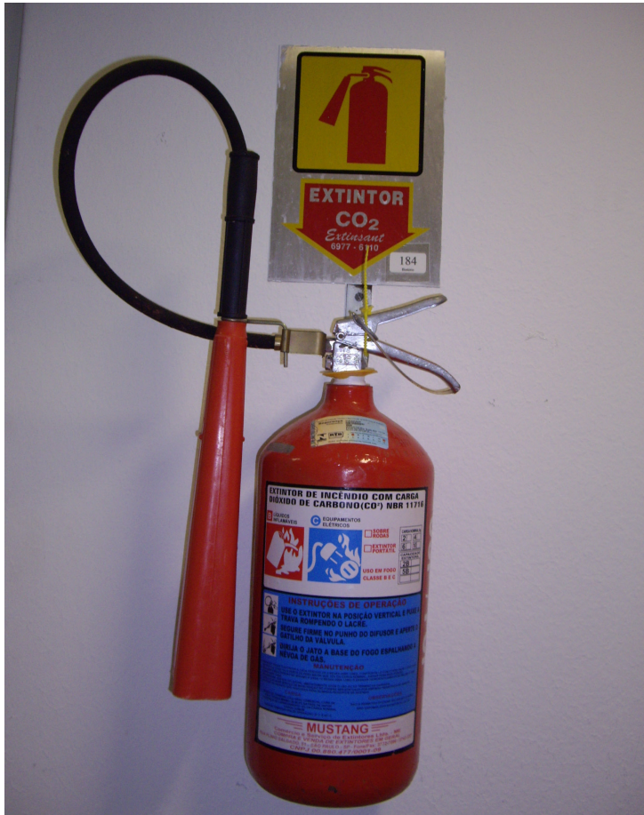
Figura 6. Extintor de incêndio
